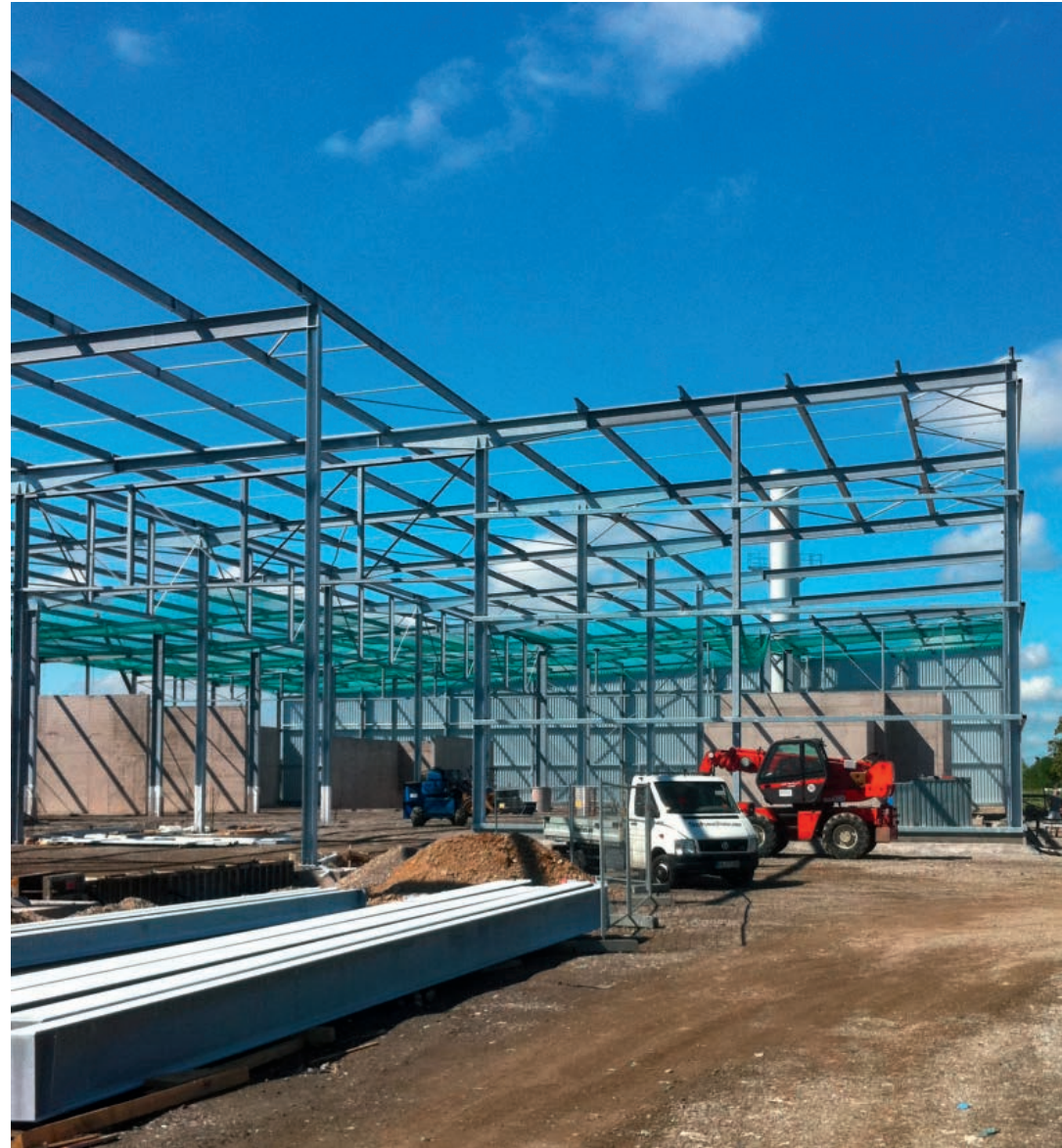
Biomassezentrum Breisgau im Gewerbepark Breisgau
