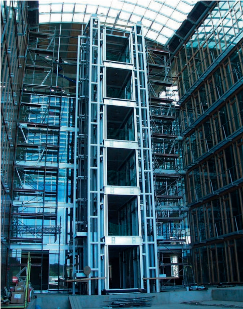
Aufzüge für die Lufthansa am Flughafen in Frankfurt
